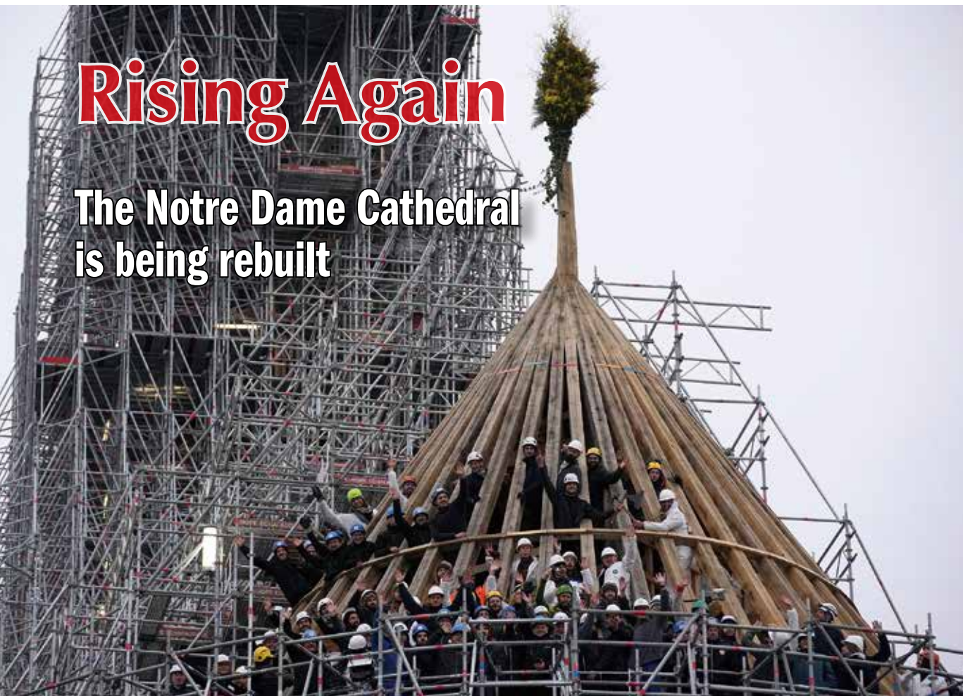
■ 骨組みが完成した修復中のノートルダム大聖堂 (2024年1月15日)
